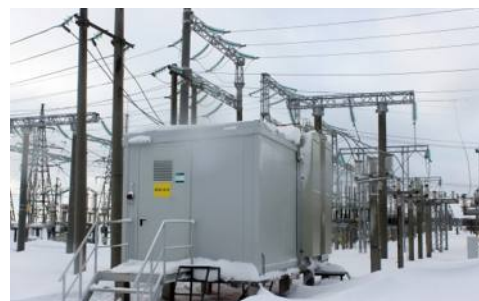
Здание ПС «Аксаково», г.Уфа
